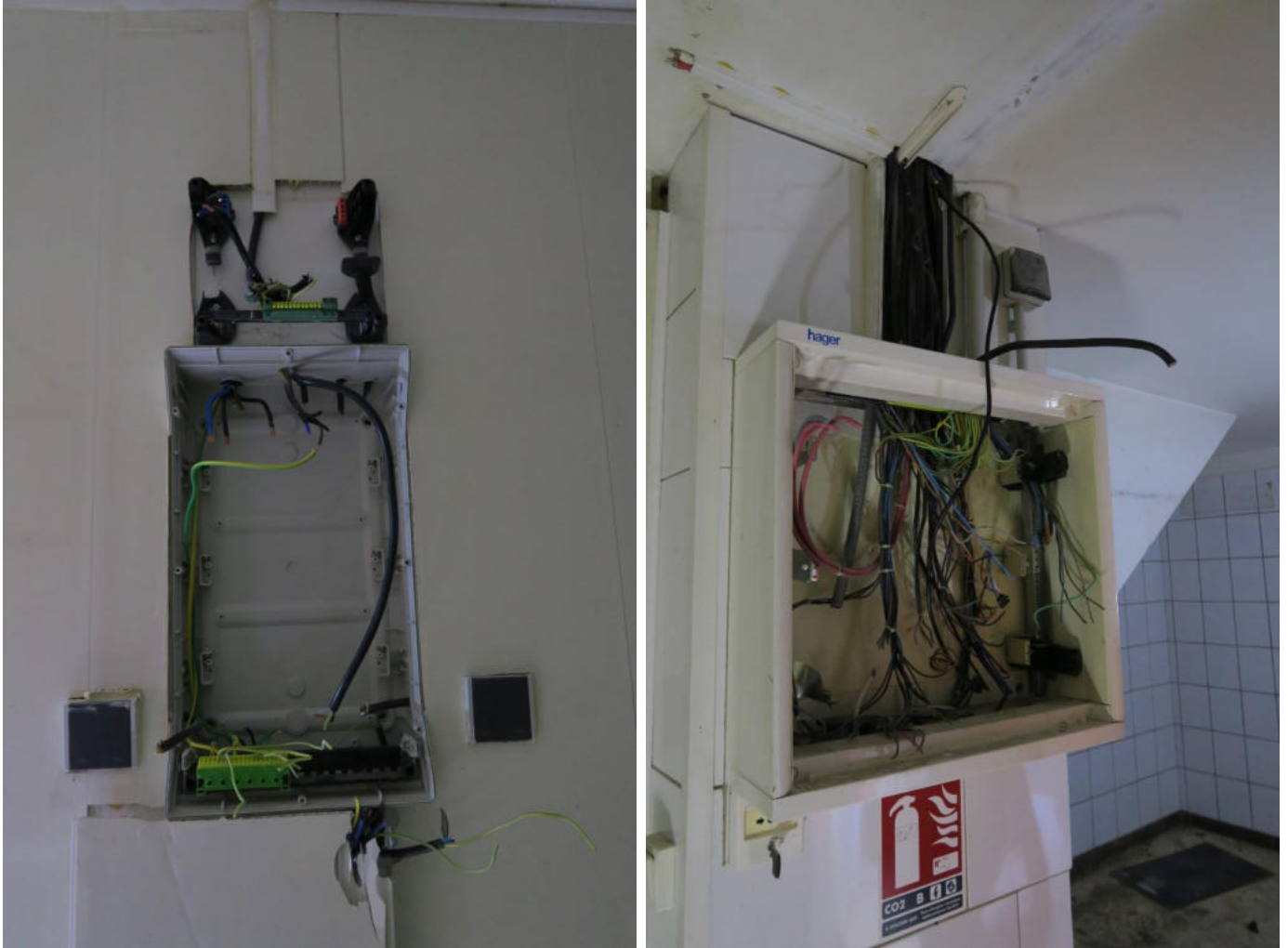
Vues tableaux électriques locaux RDC
