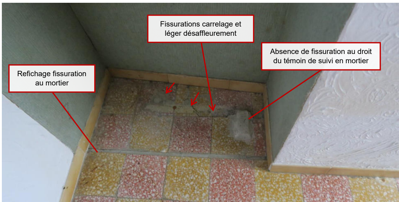
Vues fissurations carrelage plancher bas rez-de-chaussée
