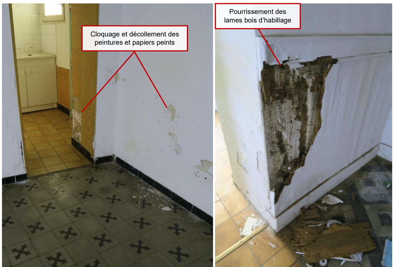
Vues remontées capillaires pieds de parois rez-de-chaussée
