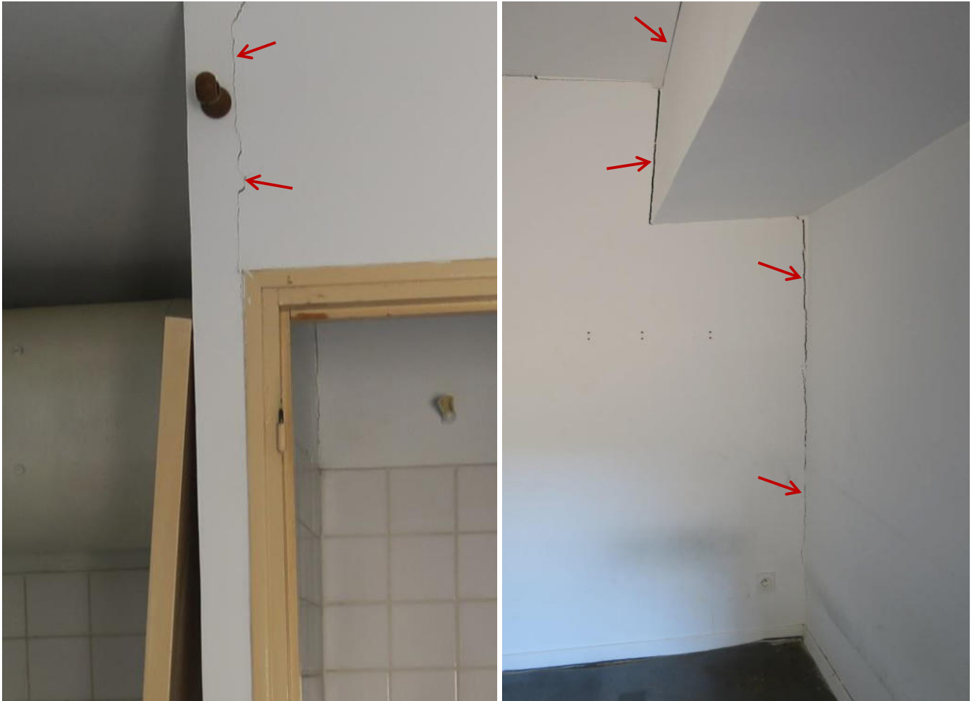
Vues fissurations parois logement Est R+2
