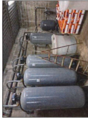
Photographie de l'installation de traitement d'eau
