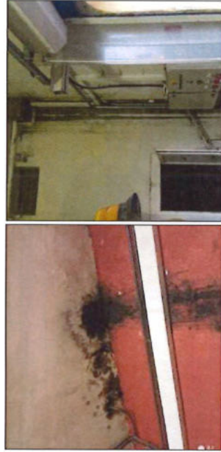
Chai viticole avec tâche d'humidité et d'infiltration d'eau depuis le plancher supérieur // Chai viticole avec tâche d'humidité et d'écoulement à proximité des réseaux électriques
