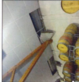
Espace de stockage du chai avec planches d'isolation de la toiture qui se détachent // Sanitaires du château avec des murs intérieurs contre la paroi rocheuse qui sont imbibés d'humidité
