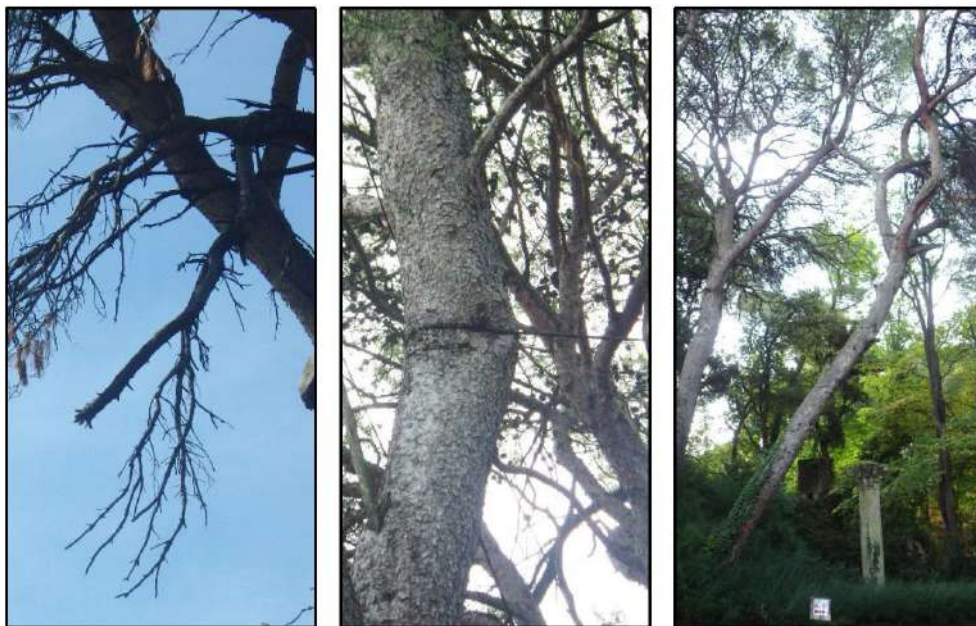
Bois mort / Strangulation par câble / Inclinaison excessive
