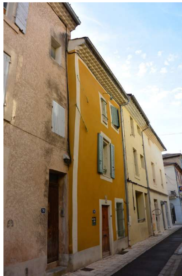
78 Rue du Pont Neuf ➤ Déformation de la façade en partie haute, trace d'un possible encorbellement
